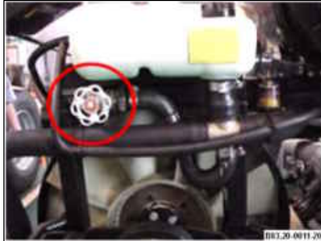
Retorno de agua del sistema de calefacción B83.20-0011-20
