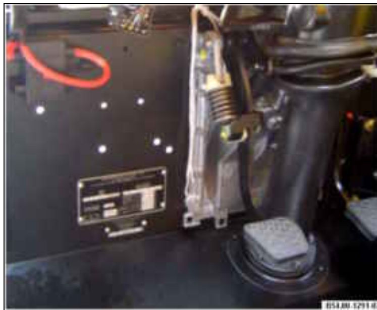
Ubicación caja del fusible general 100A (Amperios) B54.00-1291-02
