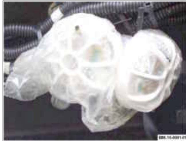
Sensores de detección de incendio B86.10-0001-01
