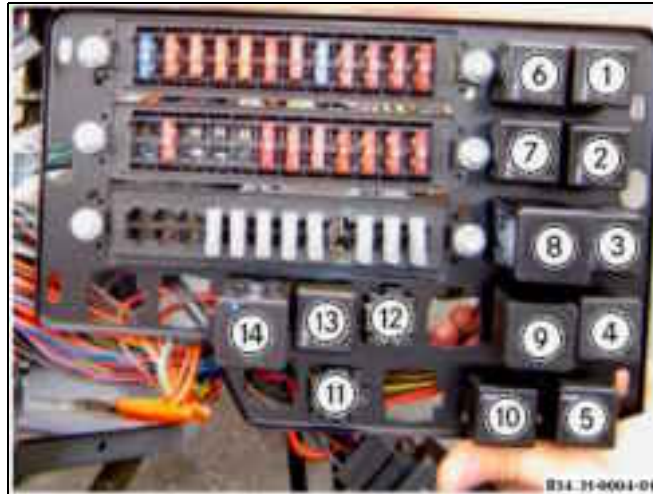
Centralita eléctrica B54.31-0004-01
