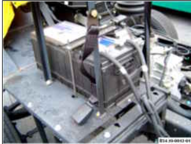
Batería ubicada debajo de la butaca del conductor B54.10-0013-01
