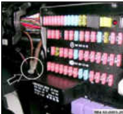
Ponto de massa na central elétrica
