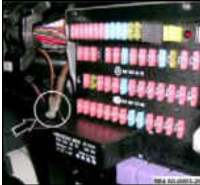
Ponto de massa na central elétrica
